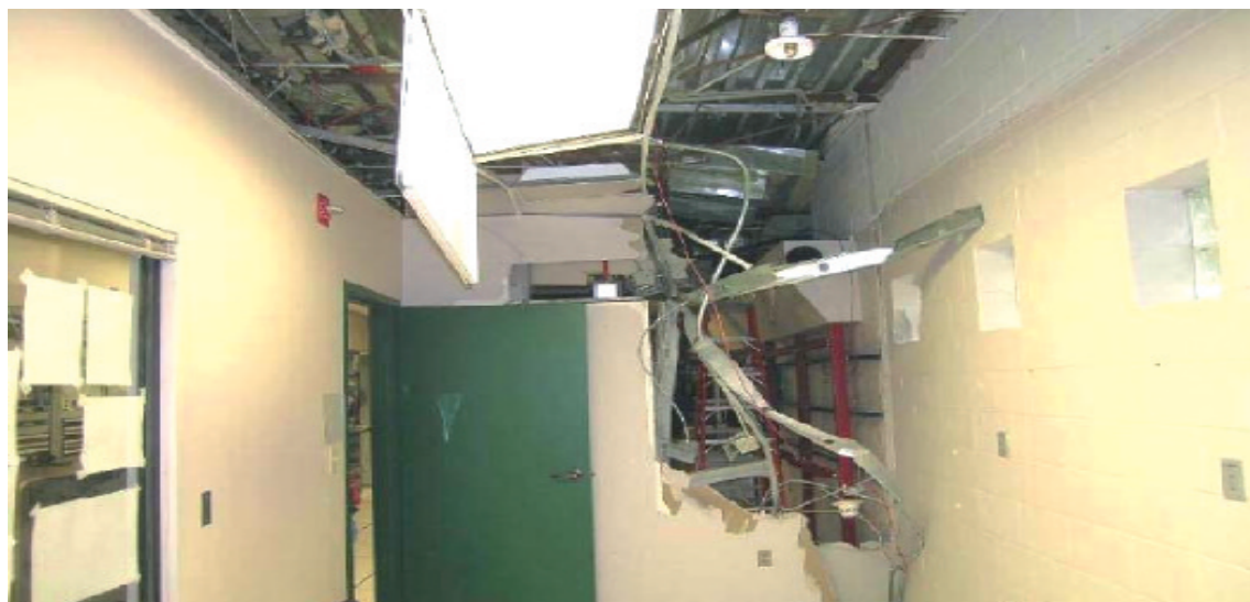
Figura 3 - Esempio di danno provocato dalla scarica di un impianto a saturazione totale: in questo caso, non sono stati previsti i necessari dispositivi di sfogo
